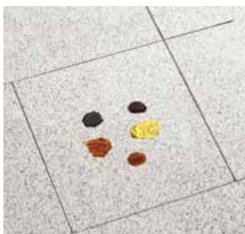
Dalles Arcadia® avant le nettoyage.
